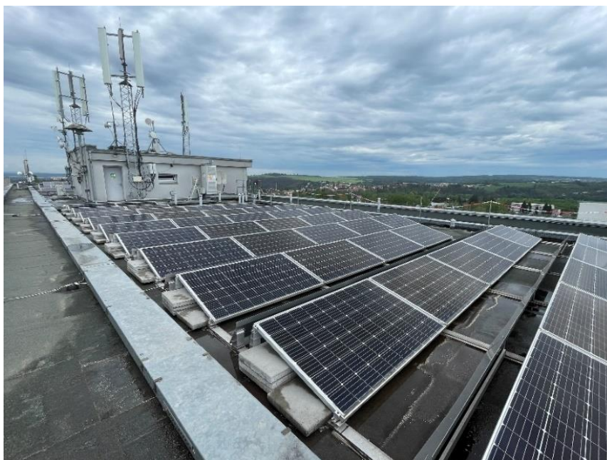
Obrázek 28 FVE umístěná na střeše objektu Odboru registru vozidel a řidičů v Koterovské ulici Zdroj: Zpracování studií proveditelnosti FVE II. etapa
